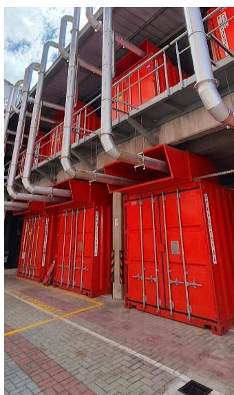
Figura: TELCONET UPS (Sistema de Alimentación Ininterrumpida)
